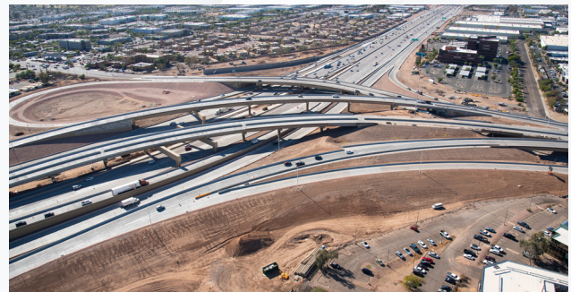
El intercambio de la SR 143 y la I-10 en 2024 después de que se abriera la nueva rampa circular de la I-10 en dirección este a la SR 143 en dirección norte y la nueva rampa de la SR 143 en dirección sur a la I-10 en dirección este.
